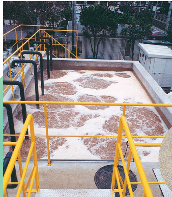
バイオネスト（曝気槽）
