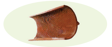
アルカリ腐食を生じた水管
