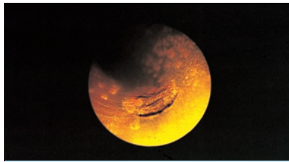
水管内部の腐食
