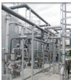
食品工場:濁度除去設備
