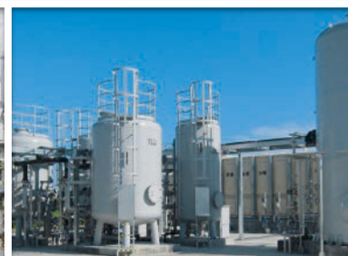
乳製品工場:工業用水処理設備
