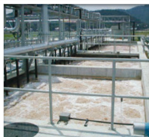
食品工場:排水処理設備
