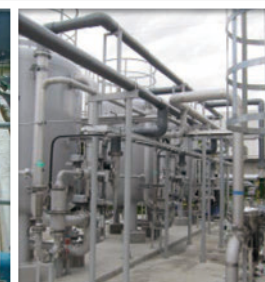
食品工場:濁度除去設備
