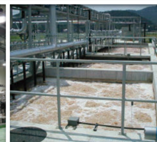
食品工場:排水処理設備
