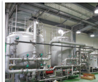
飲料工場:原料水用純水設備
