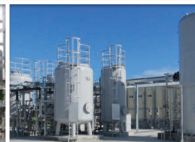
乳製品工場:工業用水処理設備
