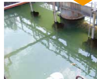
投入後 スカム発生解消
