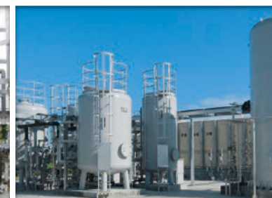
乳製品工場:工業用水処理設備
