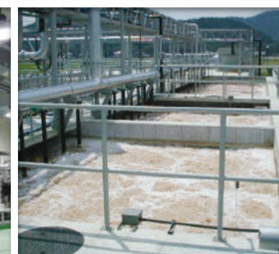
食品工場:排水処理設備
