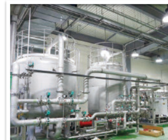
飲料工場:原料水用純水設備
