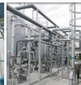
食品工場:濁度除去設備
